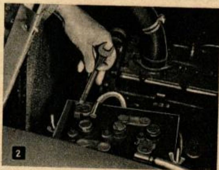
Nettoyez et resserrez périodiquement les connexions des câbles de batterie et vérifiez que la connexion de masse est bien serrée.
