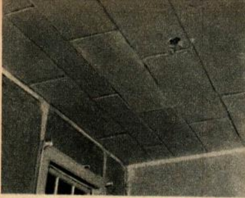
Le vieux plafond a été complètement couvert de carreaux de plâtre et il peut recevoir maintenant l'enduit et la couche finale. On met environ 12 mm (1/2 in.) d'enduit.
