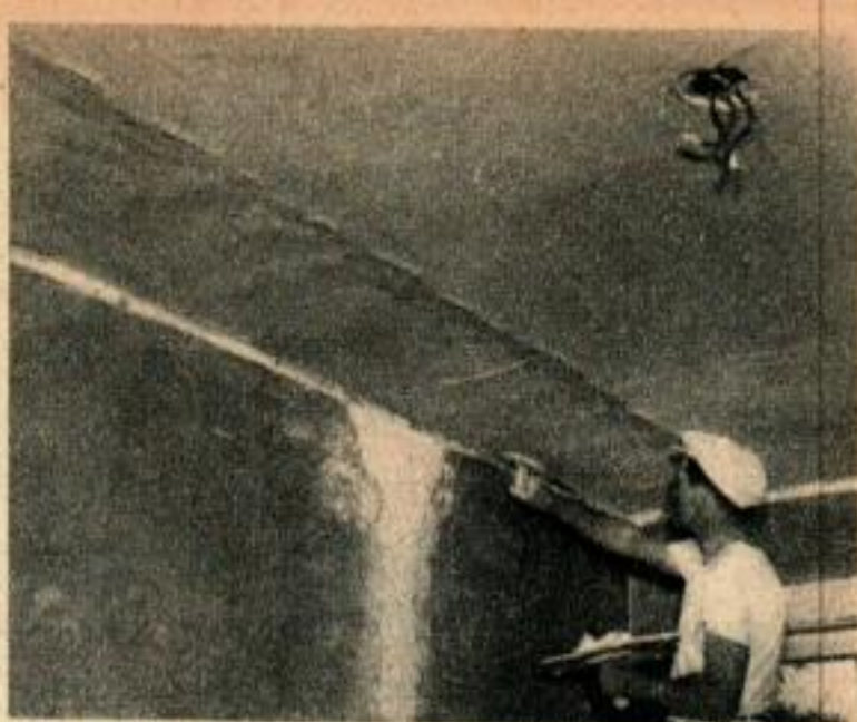
Les dernières quantités d'enduit disponibles se mettent sur le plafond en commençant par les murs, voir ci-dessus. On va donc des murs vers le centre, ce que la faible densité du mélange rend facile et rapide.
