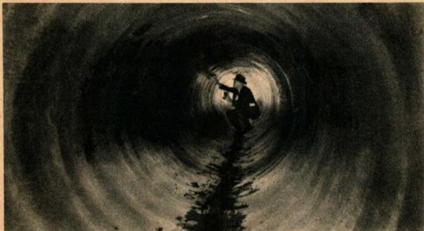
Après nettoyage, la même conduite a été grattée au hérisson et garnie intérieurement de ciment.
