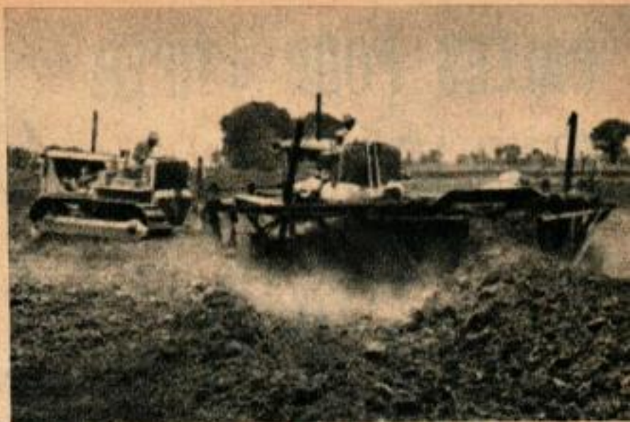
Cette machine creuse la terre et la soulève pour former des digues au long des courbes tracées sur le terrain. Elle fonctionne comme un chasse-neige de 5,50 m, mais en sens contraire.
