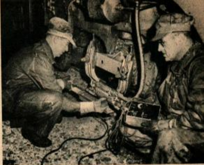
Au moyen d'une bobine à induction, les électriciens font marcher le système d'arrêt automatique qui doit bloquer le train s'il franchit accidentellement un signal d'arrêt.
