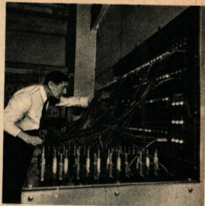
Le tableau de contrôle électrique permet plus d'un million de combinaisons d'éclairage.
