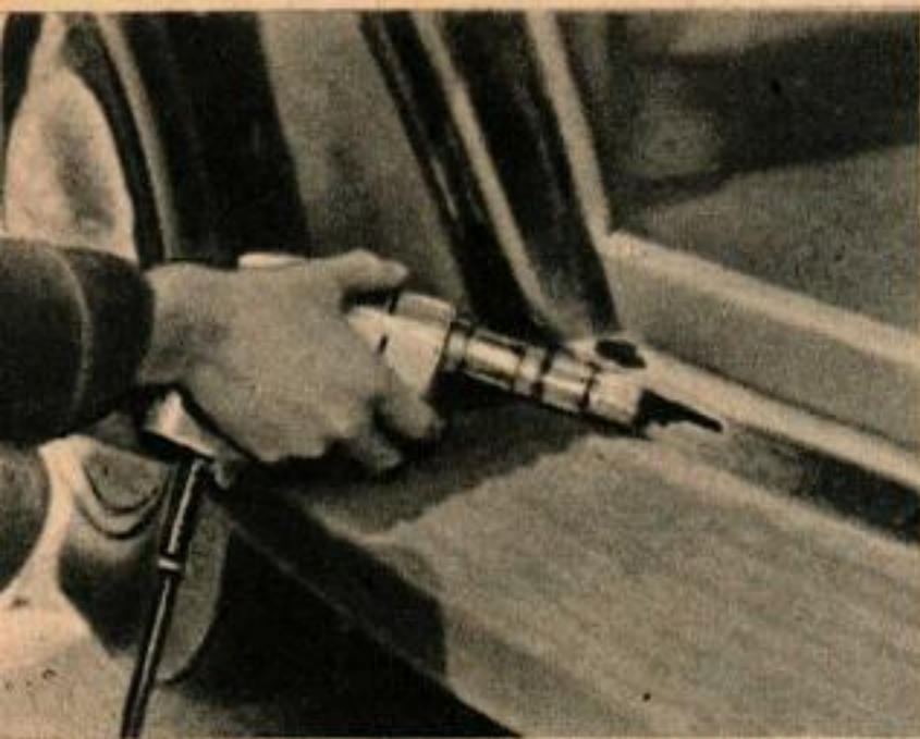
Une chignolle électrique portant une brosse métallique permet un grattage très rapide avant le rapiéçage des parties endommagées.
