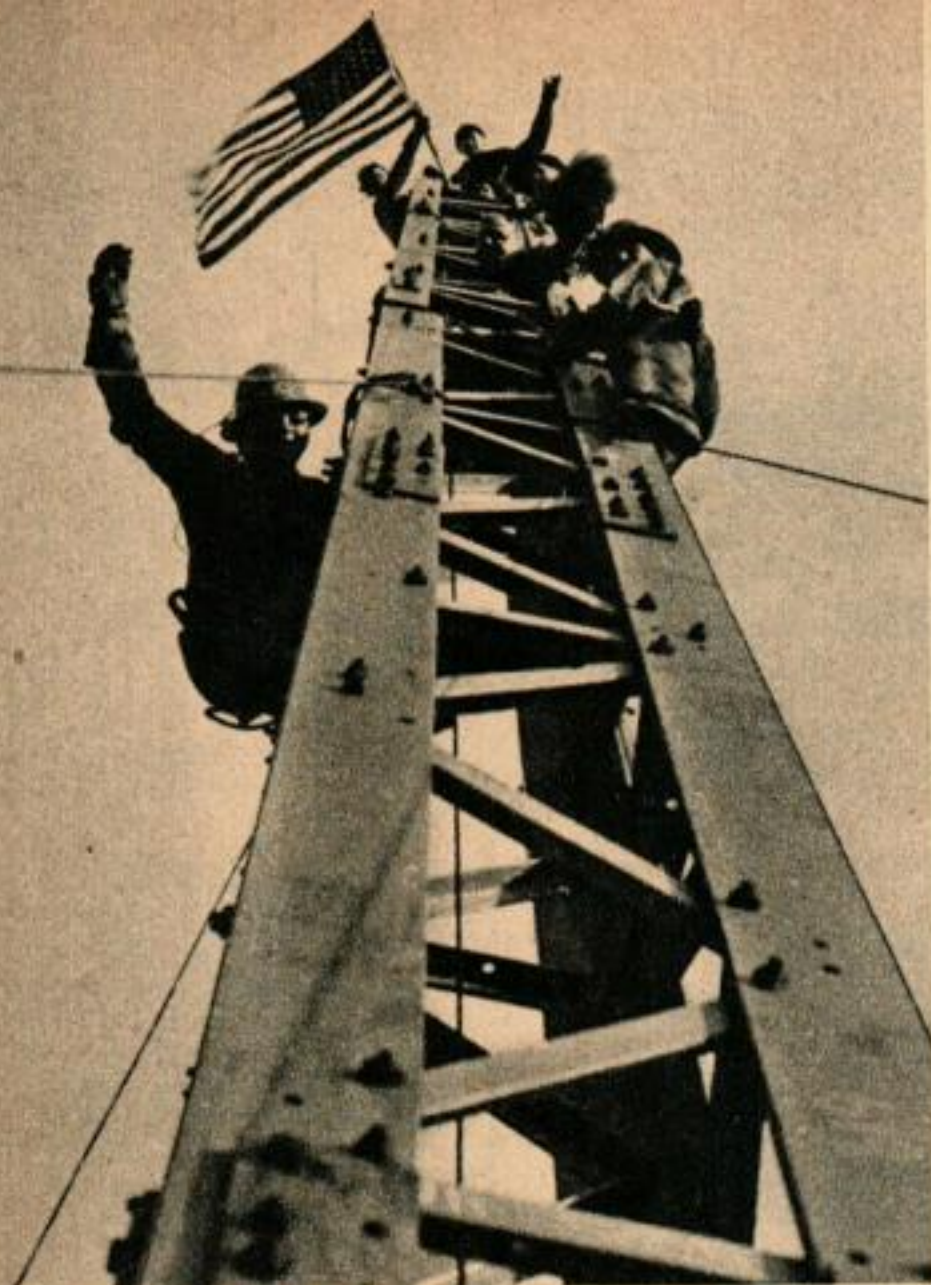
Ci-dessus: des hommes-mouches perchés sur le bâtiment le plus élevé qu'ait édifié l'industrie humaine: le mât de l'Empire State Building, haut de 448 mètres. Vue générale du mât, à droite, montrant le premier élément que l'on installa au sommet.
