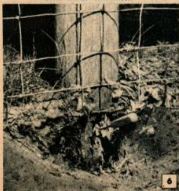
Les bois non traités arrivent en 3 à 5 ans à ce stade de corrosion.
