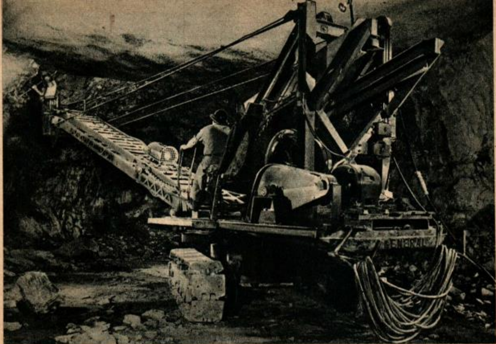
Dès que l'abattage est terminé, on envoie un mineur au haut d'une échelle mobile pour faire tomber les petits éclats encore attachés et qui pourraient ultérieurement provoquer des accidents.
