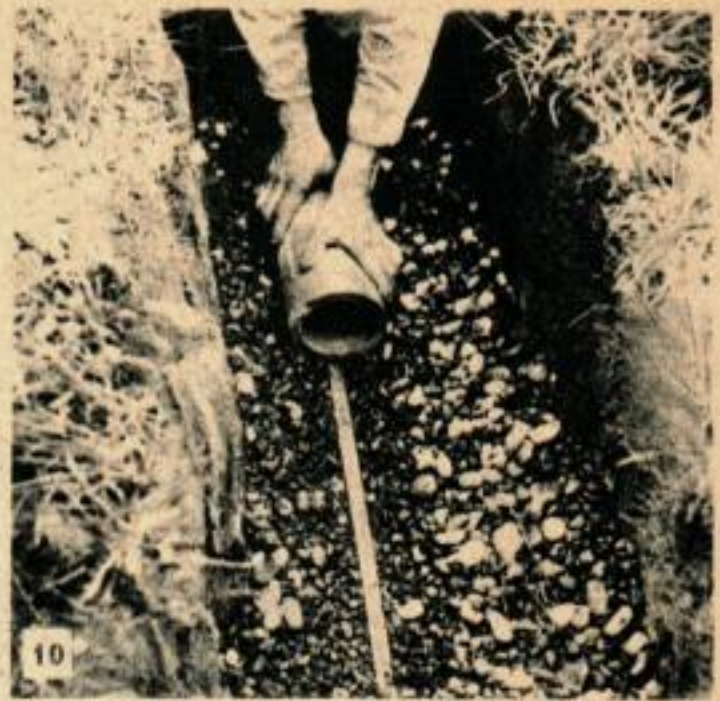
Dans les terres peu perméables où le drainage est lent, les tuyaux doivent être posés sur un lit de gravier propre.
