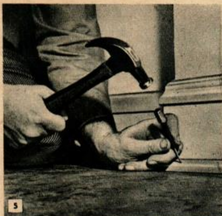
5 Gratter le cordon de crasse formé sur le plancher ou la plinthe et replacer la moulure au niveau du sol.
