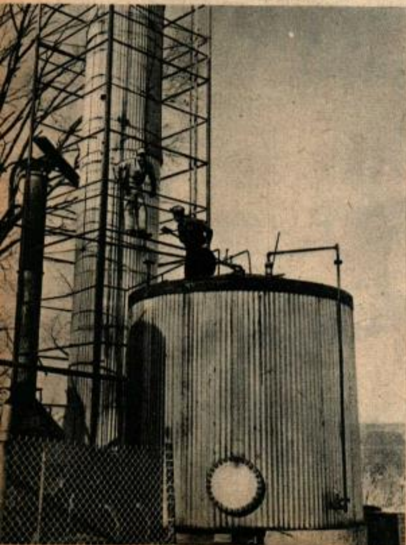
Ci-dessous, la cuve de traitement acide à l'usine de Worthington. L'addition d'un acide facilite la précipitation des matières solides.
