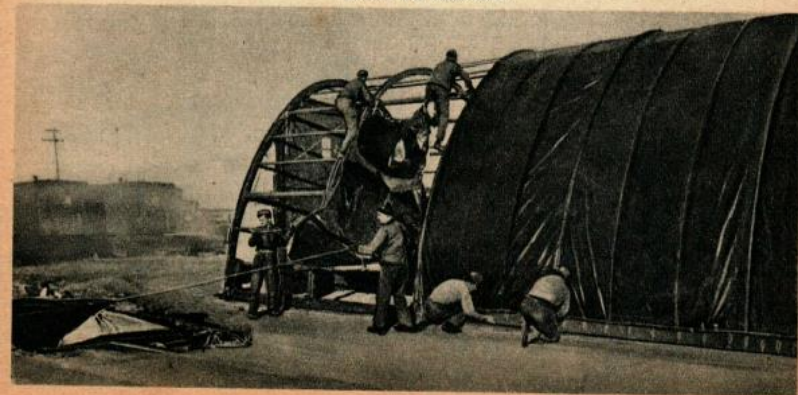
Une couverture en tissu de verre est étendue sur une charpente en bois, ce qui constitue un atelier de réparations portatif très confortable.
