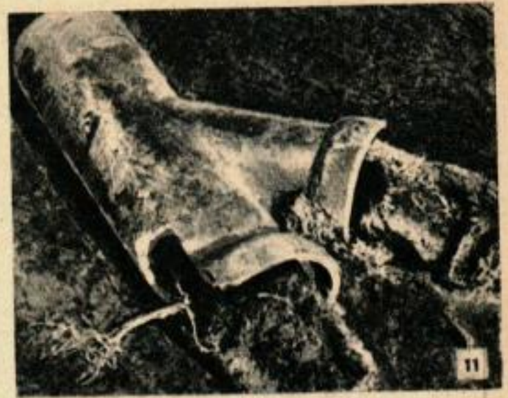
Tuyau complètement bouché et rompu par la croissance des racines dont certaines ont un diamètre de 6 mm.
