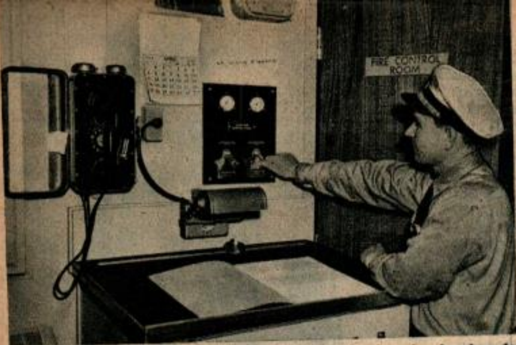
Un système d'alarme sonore se déclenche dans la chambre de garde dès que les contrôles électroniques détectent de la fumée quelque part sur le navire.
