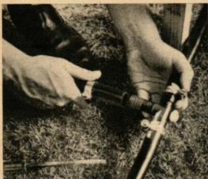
LES CANALISATIONS LATÉRALES sont fixées avec un raccordement interposé dans la canalisation principale. Le système qu'on voit est celui de Buchner.
