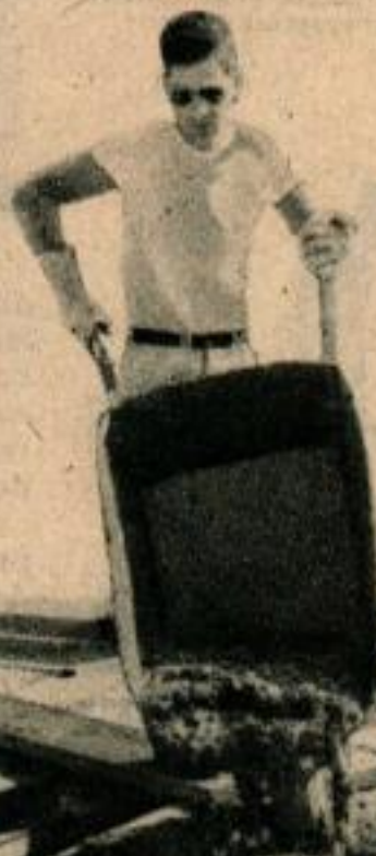
En bas, l'aggloméré de sciure bien que de texture grossière, se répand très facilement. Ici les ouvriers recouvrent le grillage en fil de fer renforcé d'une épaisse couche du mélange pour former une solide dalle de plancher.
