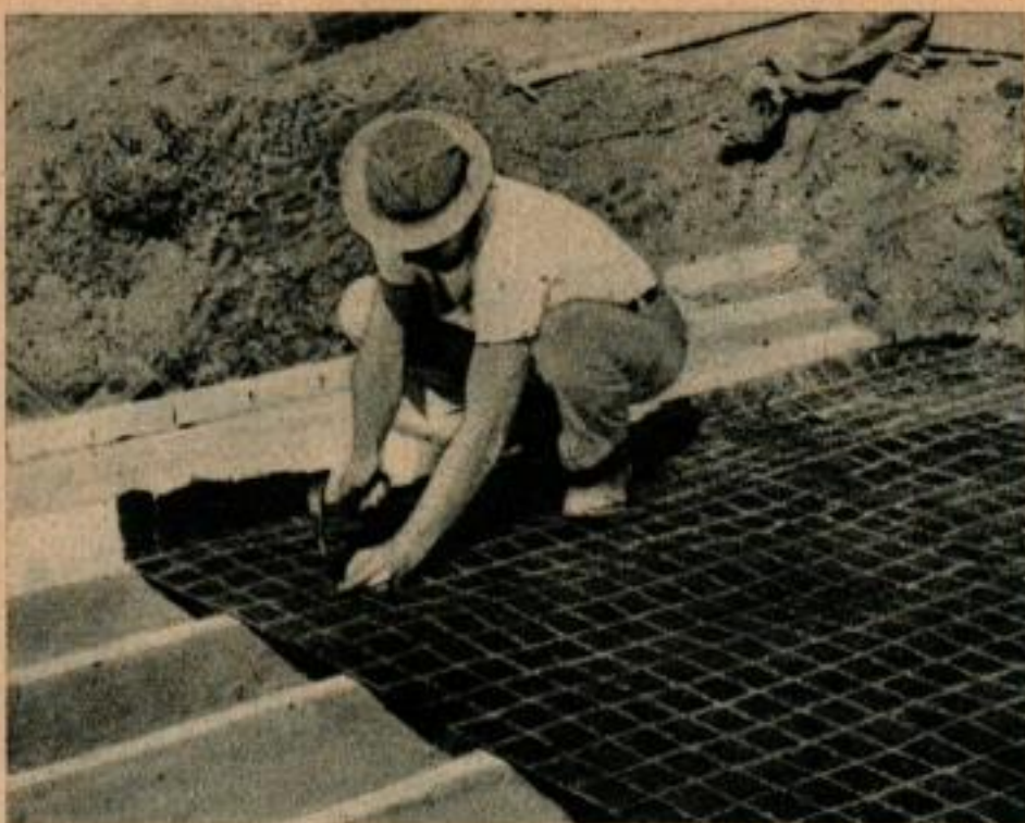
En haut, du grillage de fil de fer renforcé et cloué sur les solives avant de couler le plancher.
