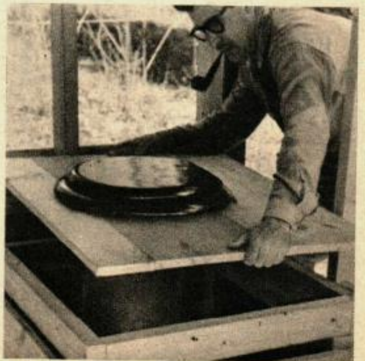
LA CAISSE CONSTRUITE sur le tonneau porte un siège normal de W.-C. En-dessous le haut du tuyau galvanisé est fixé à la plate-forme de 610 de côté.
