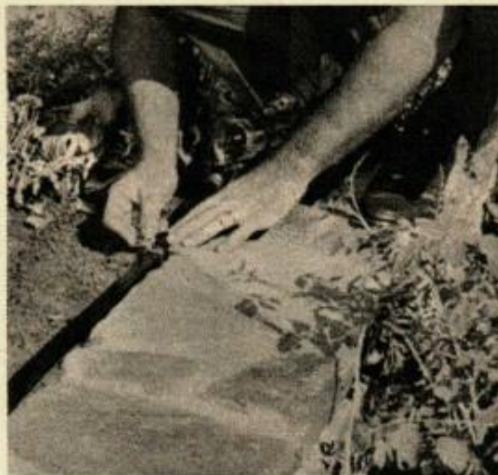
UN TUYAU SOUPLE A SECTION CARREE est le secret du nouveau système d'arrosage conçu pour être monté le long des fondations et des plates-bandes. Des cavaliers maintiennent le tuyau en place.
