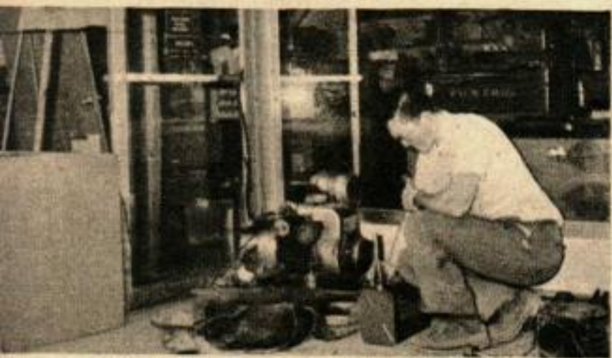
LE GROUPE DE SECOURS permet de faire marcher un ventilateur pour sécher le magasin. L'humidité a persisté longtemps après la fin de l'inondation.
