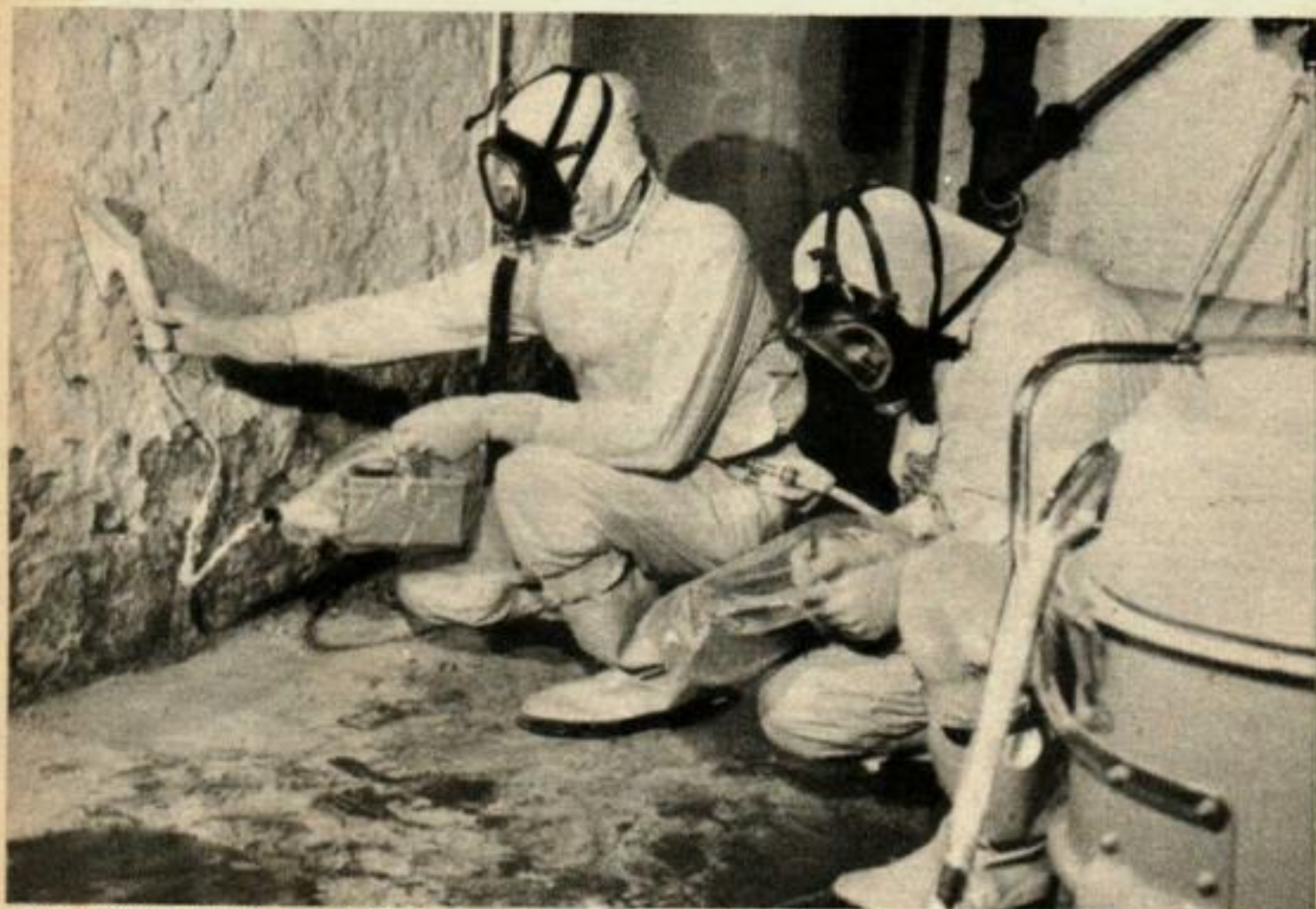
LE SOUS-SOL D'UNE MAISON de Landsdowne contaminé par le radium est inspecté par des spécialistes revêtus de combinaisons de protection.
