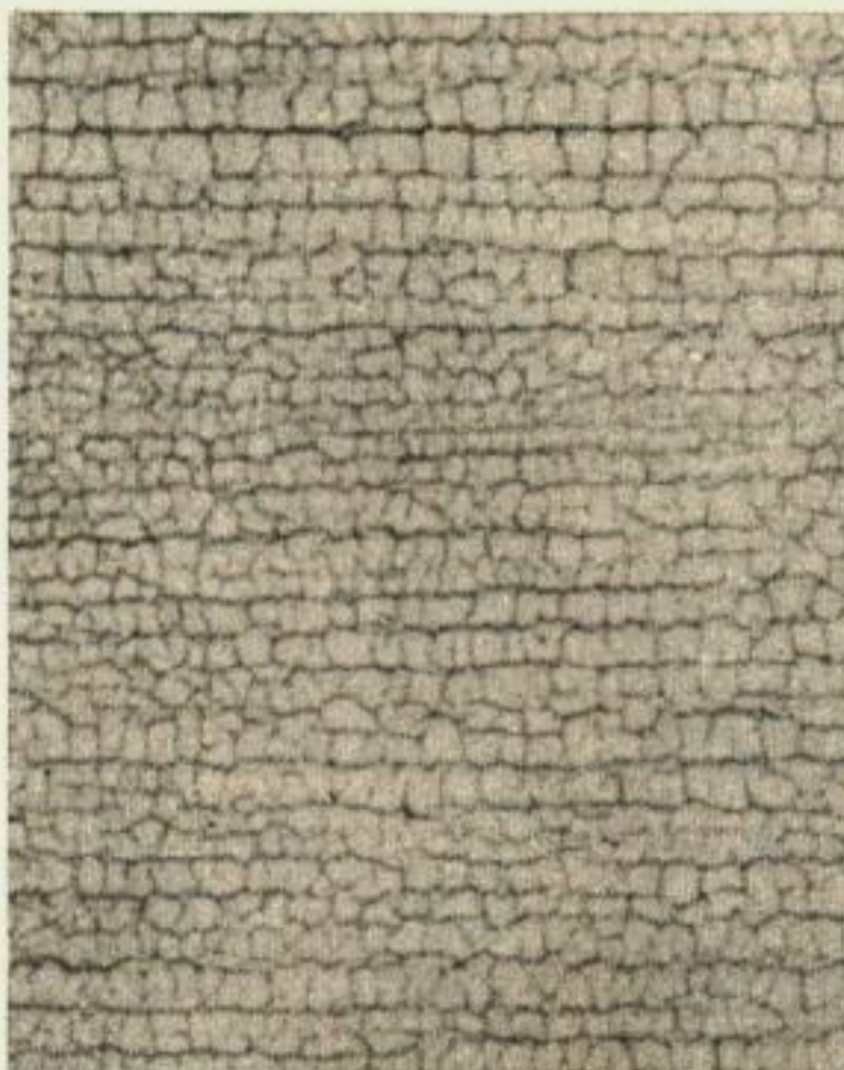
Voici une peinture en peau d'alligator bien formée. La cause en est une peinture de mauvaise qualité ou un séchage insuffisant entre les couches.
