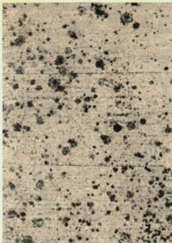
Voici de la moisissure bien avancée. On la prend souvent pour de la saleté. Pour en avoir le cœur net : lavez. La poussière s'en va, la moisissure reste.
