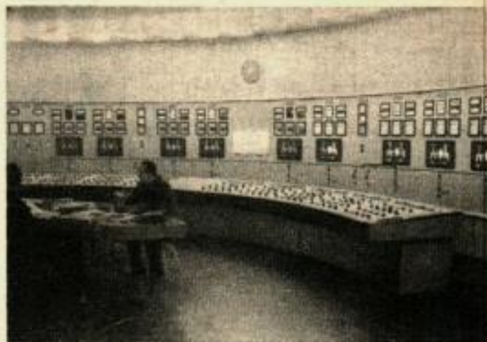
DANS LA SALLE DES COMMANDES en grande partie automatisées, on reconnaît le tableau lumineux qui indique l'état de fonctionnement de chaque ensemble de machines. Au premier plan, les tableaux lumineux de quatre machines déjà en activité de la première tranche de construction. Vianden est relié par une ligne directe au distributeur central de charge de Branweiler près de Cologne.
