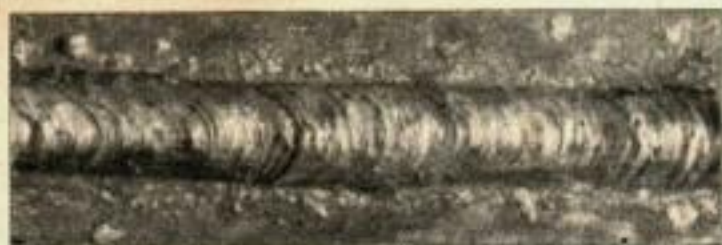
Bonne soudure bout à bout sans espacement. La photo ci-dessous montre une mauvaise soudure avec espacement (globules).
