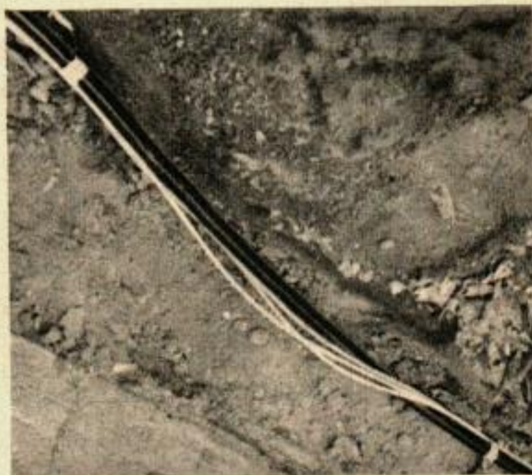
Les conduits de contrôle des clapets hydrauliques devraient être posés, pour des raisons pratiques, dans la même tranchée que le tuyau.
