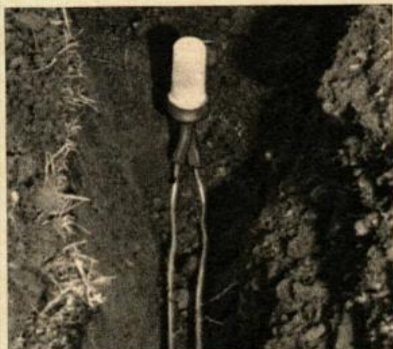
L'hydrostat, détecteur d'humidité, est branché au dispositif et au clapet de contrôle par deux tuyaux vides en cuivre.
