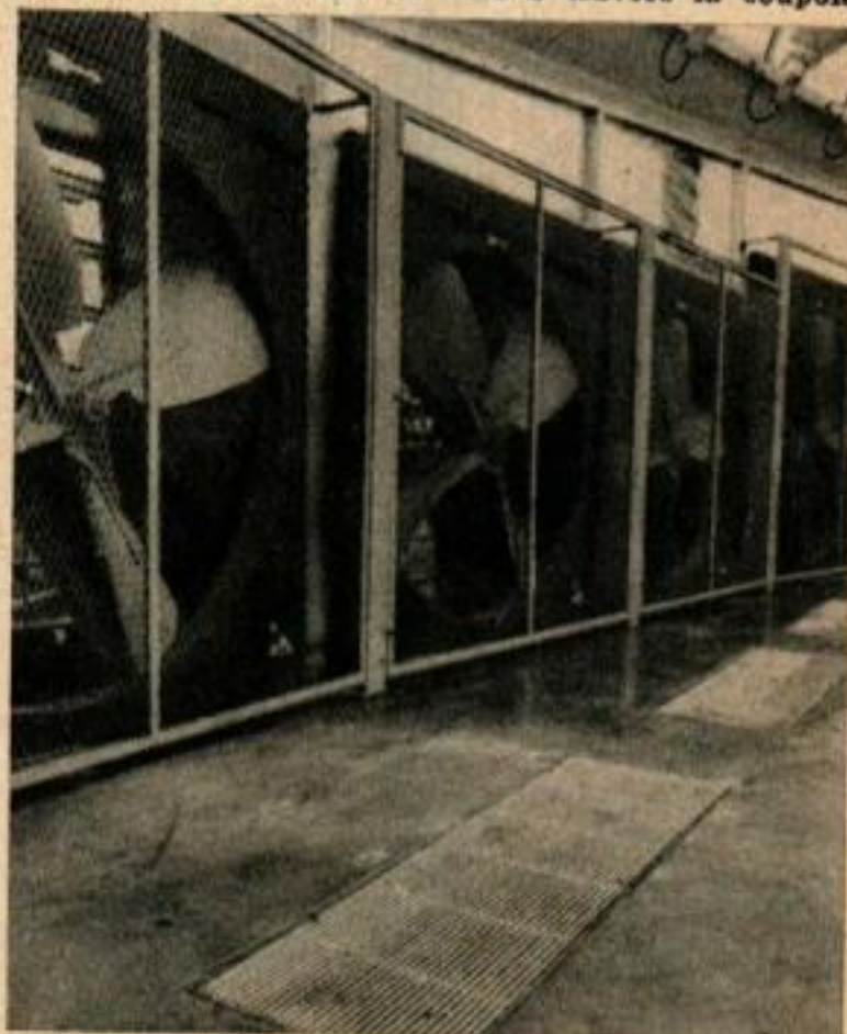
Ci-dessus, disposition du « Climatron ». Ci-dessous, les ventilateurs d'évacuation qui règlent automatiquement l'écoulement de l'air à travers la coupole
