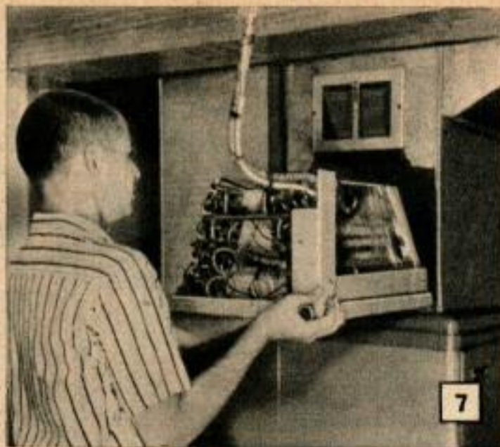
Le serpentin est installé dans la chambre à pression de la chaudière. Remarquez la tubulure flexible connectant l'élément avec le compresseur monté à l'extérieur du mur.
