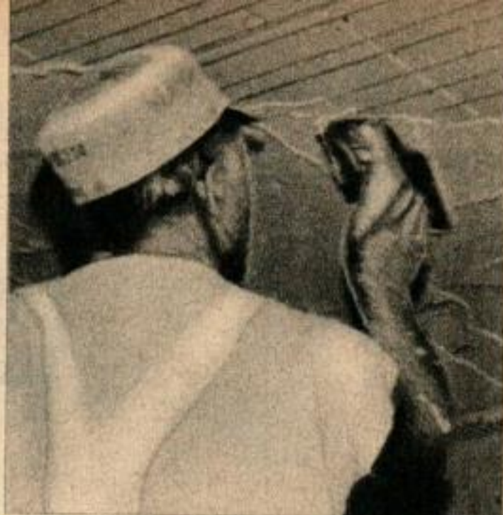
Les serpentins sont recouverts de plâtre. La chaleur radiante chauffe la finition plâtrée et s'irradie doucement à travers la pièce.
