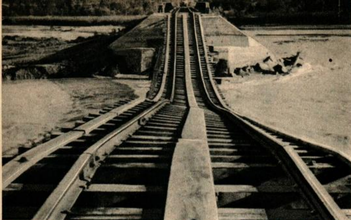
Les rails sont restés suspendus dans les airs après qu'une inondation eut balayé les supports du viaduc. Les inondations sont une menace constante.
