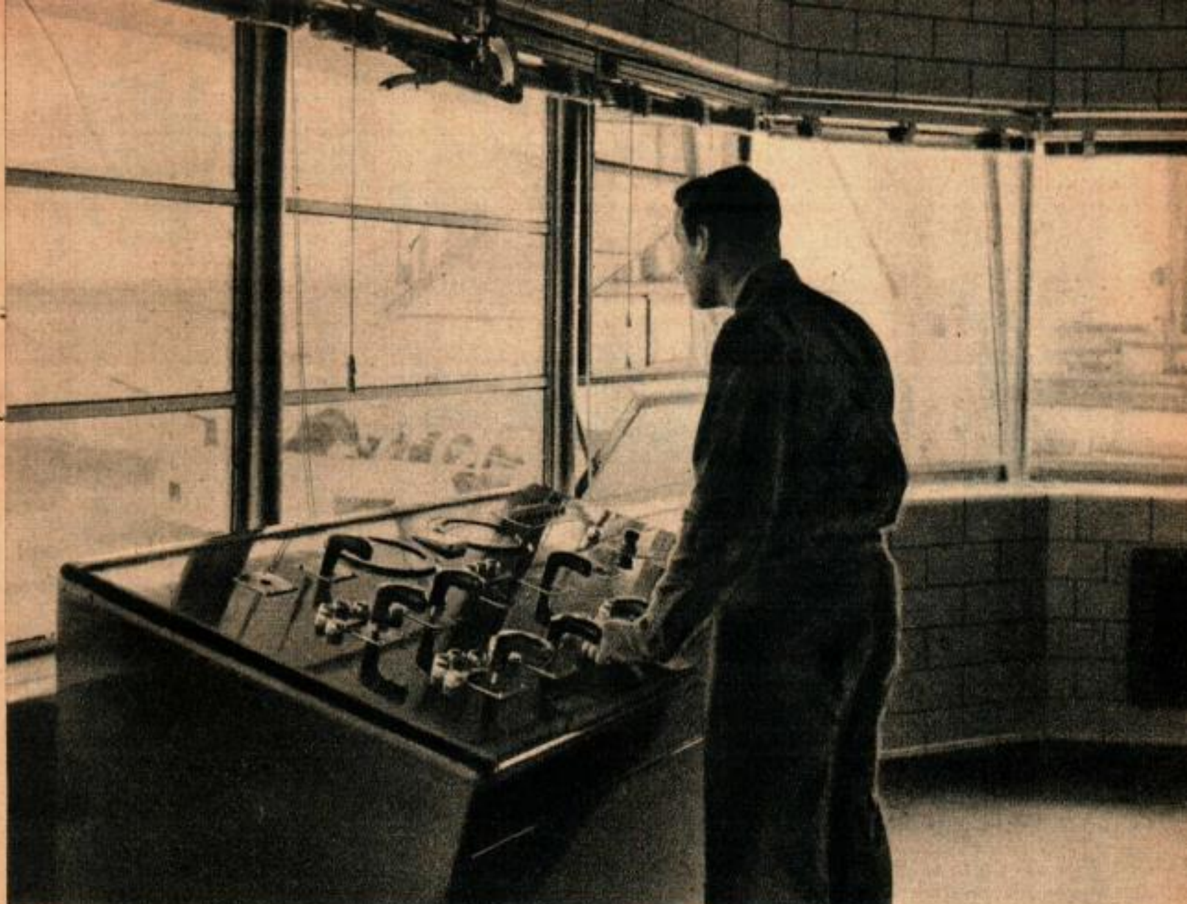
Les commandes des vannes et des portes des écluses se trouvent sur des consoles de ce genre. Des lampes-témoins empêchent l'opérateur de commettre des erreurs.
