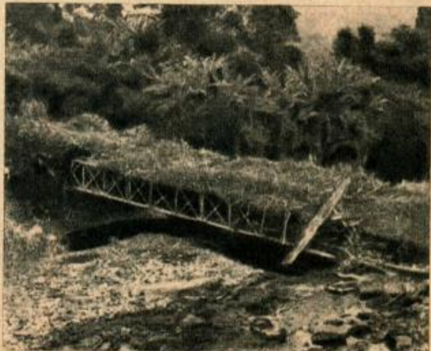
Cette carcasse d'un pont Bailey, entièrement recouverte de végétation, est caractéristique des effets de dix années de chutes de pluies.
