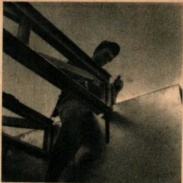
Les fermes du toit s'emboîtent dans des fentes pratiquées dans les murs latéraux, dispositif qui assure une grande rigidité à la structure.
