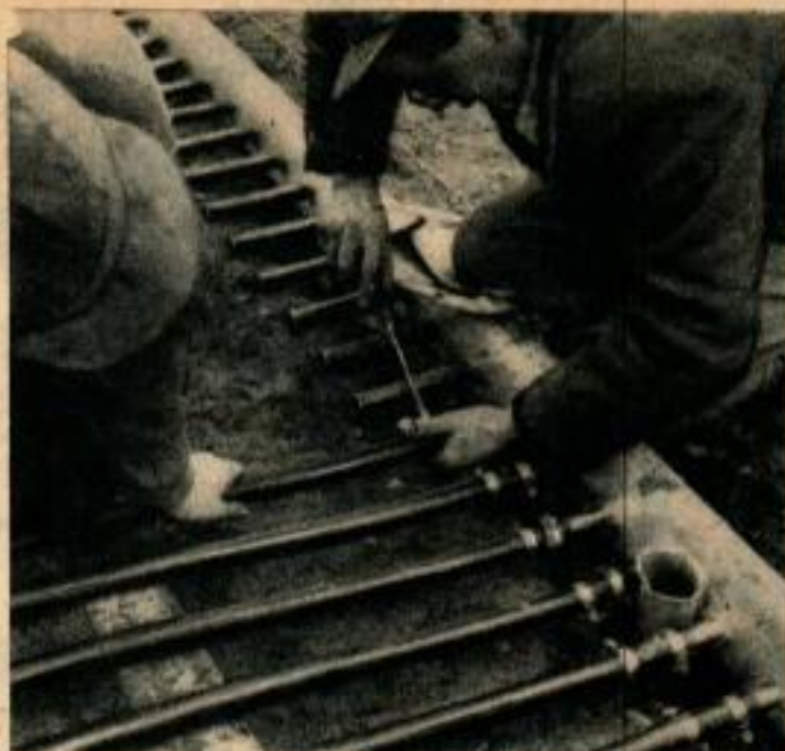
Les tubes plastiques dans lesquels circule le fluide réfrigérant sont connectés à la ligne d'alimentation de la patinoire.
