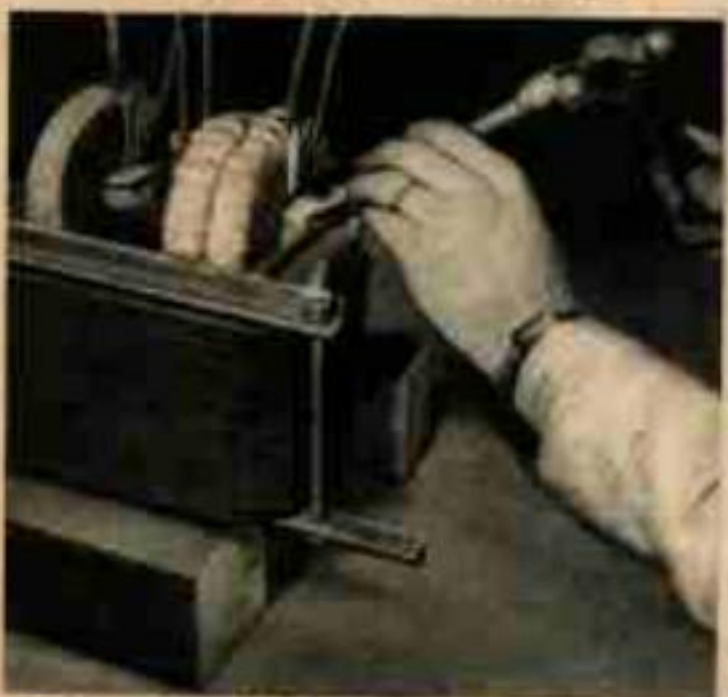
12. Des cales en bois dur sont enfoncées entre les bobinages et le noyau; l'isolation des enroulements est protégée par des bandes de papier ou de fibre.
